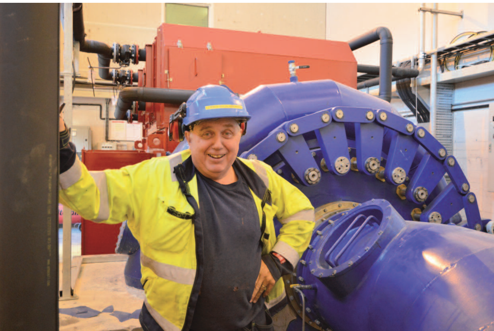
Maskinmester Stig Solberg i maskinsalen på Rekvatn kraftverk.
