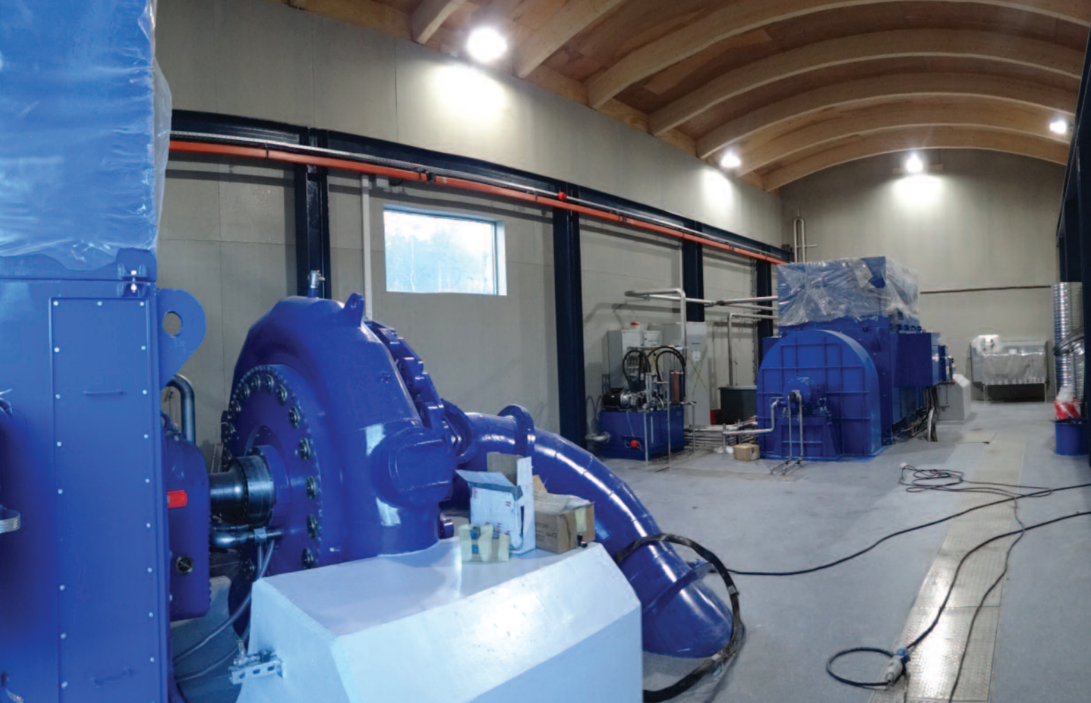
Maskinsal Forsanvatn kraftverk.
